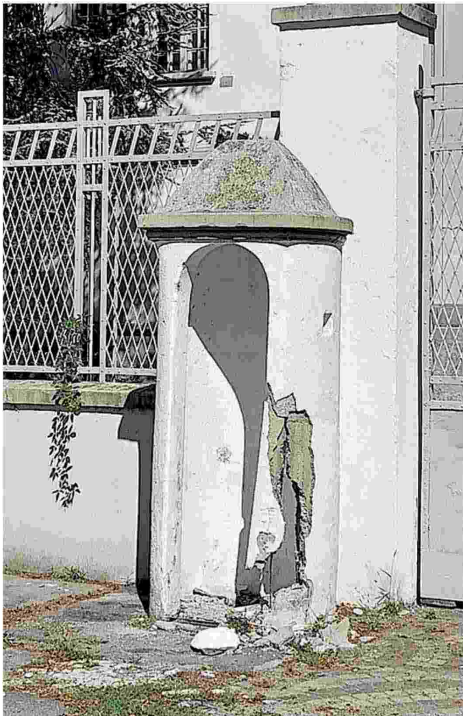
La garitta dell'ex caserma danneggiata
