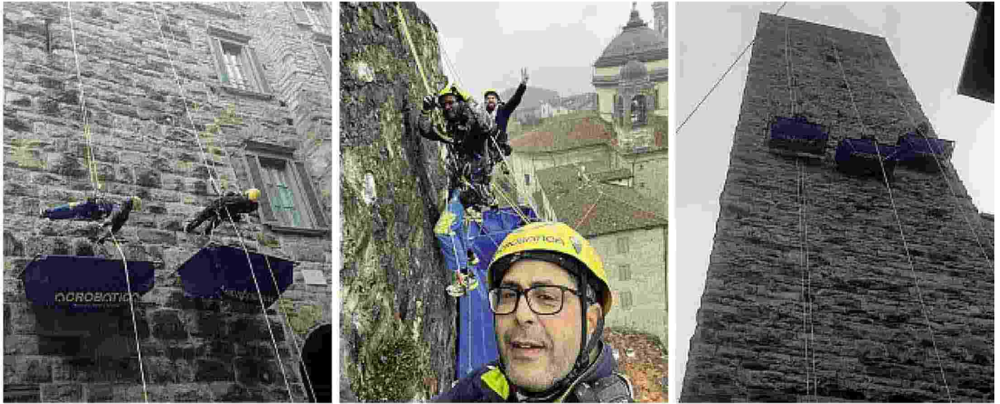
EdiliziAcrobatica I tecnici specializzati milanesi hanno iniziato a scalare la torre per i controlli alle 8 di ieri mattina. L'intervento sarà concluso nella giornata di oggi
